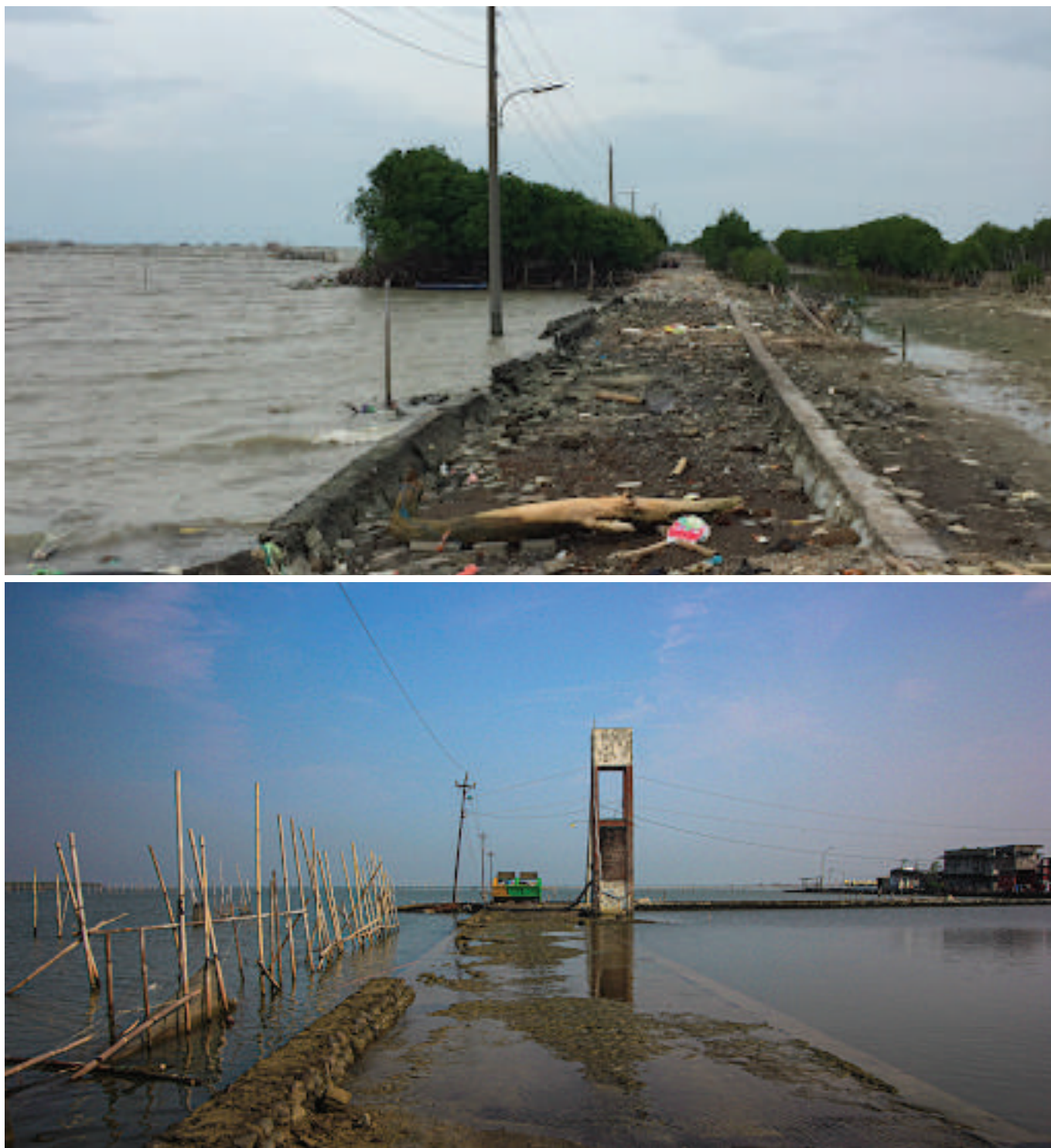
Gambar 19. Rusaknya infrastruktur di Sriwulan, Demak
