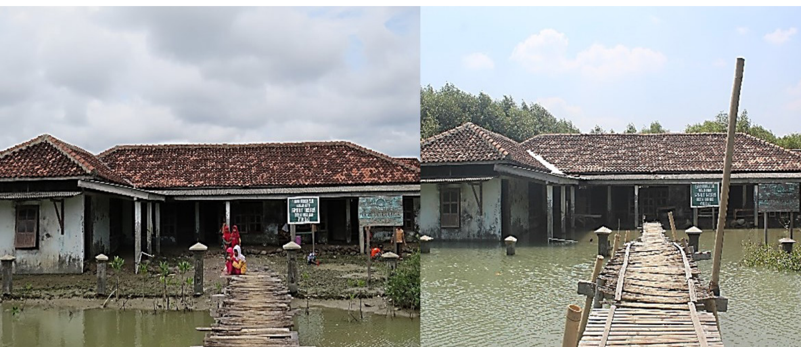
Dampak penurunan muka tanah yang terjadi di salah satu dusun di Desa Timbulsloko, Demak. Kiri: Kondisi pada Januari 2016 (Foto: Yus R. Noor); Kanan: Kondisi pada Agustus 2018 (Foto: Triana)
