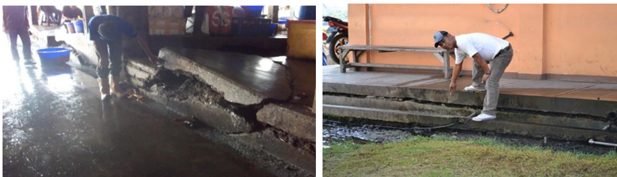
Gambar 7. Dampak subsiden tanah, yaitu kerusakan infrastruktur yang banyak terjadi di Kota Jakarta dan Semarang.
