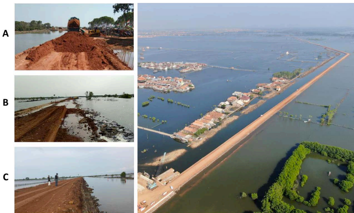
Gambar 11. Pembuatan tanggul di pinggir pantai untuk mencegah banjir pasang laut “rob” yang diakibatkan oleh subsiden tanah di Kota Pekalongan. Kondisi beberapa saat setelah proses pengurangan tanah tanggul (A), Kejadian “rob” datang kembali (B), Tanggul harus ditinggikan lagi akibat “rob” datang kembali (C). Foto courtesy Hakam dan BBWS.
