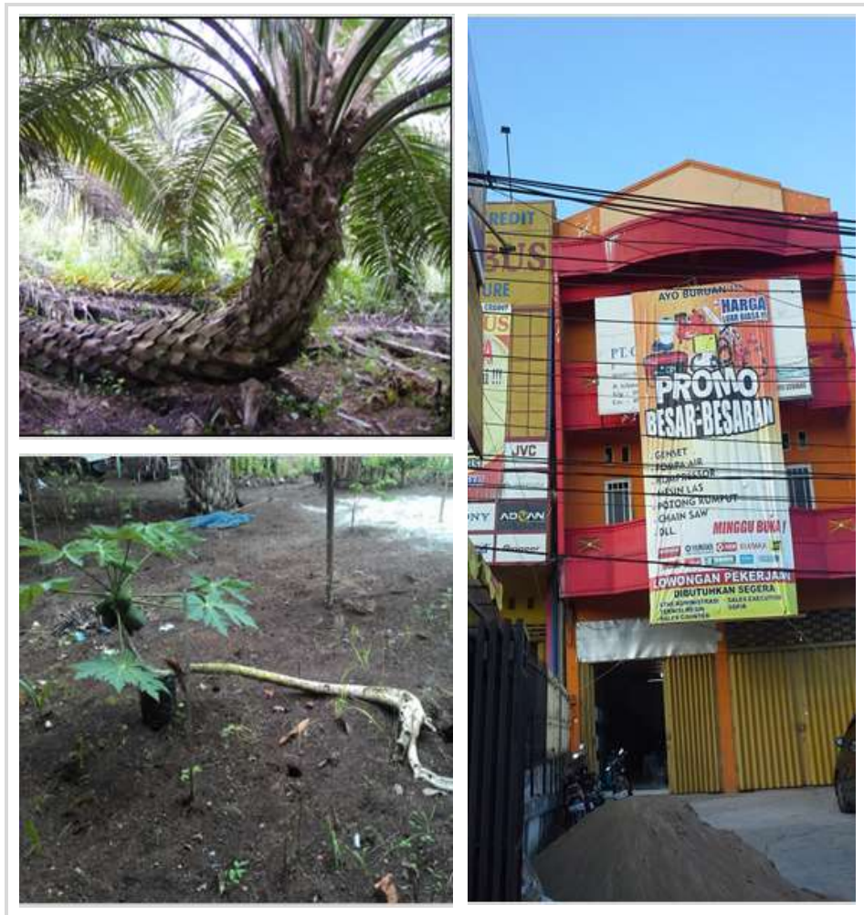
Gambar 12. Tumbangnya pohon sawit (di Sulawesi Barat) dan papaya (di Palalawan, Riau) serta miringnya bangunan (di Banjarmasin) sebagai akibat terjadinya penurunan permukaan lahan gambut/subsiden. (Foto oleh Nyoman Suryadiputra, 2015)
