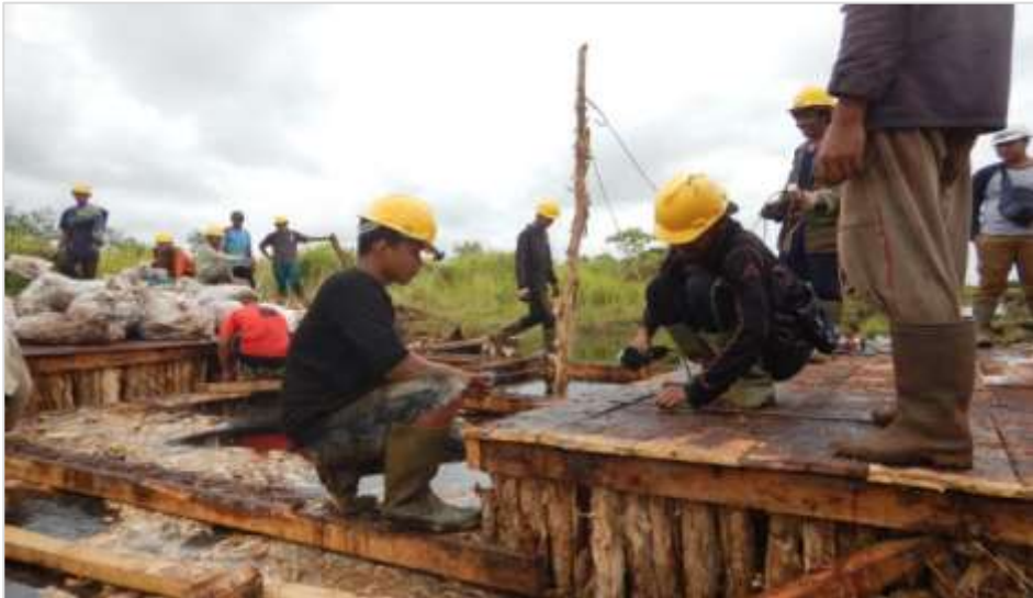
Gambar 50. Penyekatan kanal di bagian barat laut HLG Londerang, dekat Desa Teluk Dawan (Foto. WWF-I, 2017)
