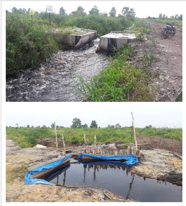
Gambar 52. Sekat kanal di APL yang dibangun WWF-I Proyek Rimba (atas), dan dibangun PT ATGA (bawah). Foto Nyoman Suryadiputra, Des-2017.
