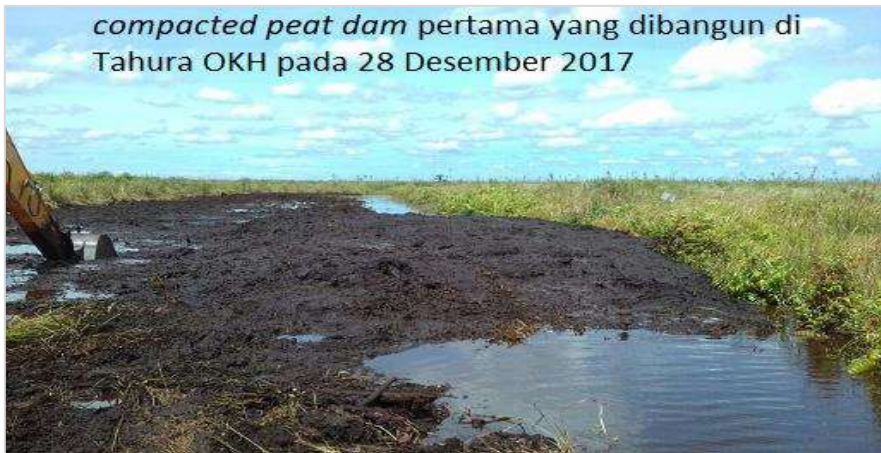
Gambar 67. Salah satu sekat kanal ( compacted peat dam ) yang sudah dibangun di dalam Tahura OKH (Desember 2017; Foto oleh Jarwo Susanto).
