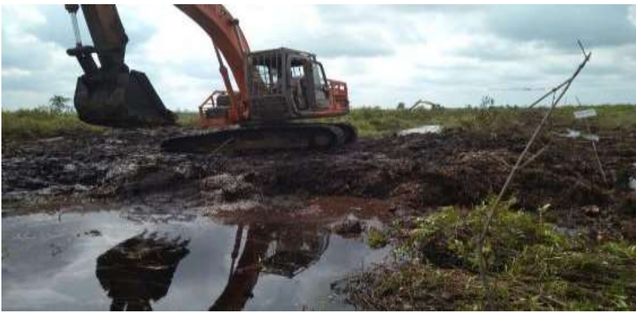
Gambar 78. Pembuatan sekat di kanal primer (lebar 35 meter) oleh 2 buah ekskavator (kiri, foto oleh Nyoman Suryadiputra Feb. 2018) dan pemadatan sekat menggunakan ekskavator (kanan, foto oleh Jarwo Susanto, Jan 2018).
