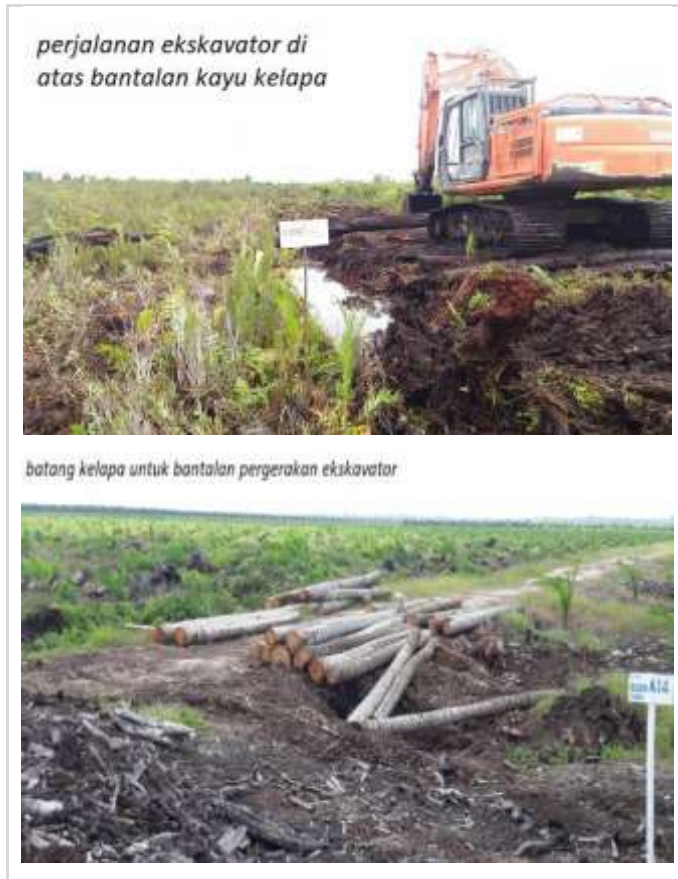
Gambar 71. Pergerakan ekskavator di atas bantalan batang kelapa untuk mengurangi/mencegah ambelasnya permukaan gambut (Foto oleh Jarwo Susanto dan Nyoman Suryadiputra Feb. 2018).
