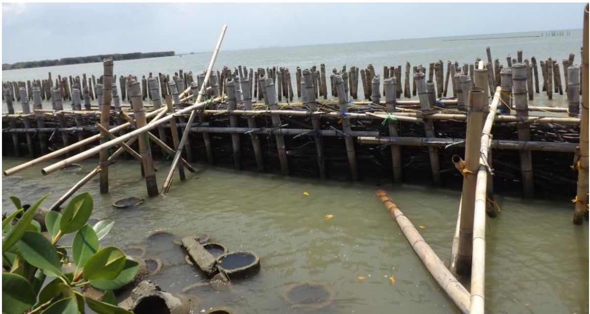
Gambar 5. Struktur permeabel di Desa Bedono, Kecamatan Sayung Kabupaten Demak. Pada latar depan terlihat bekas bangunan pemecah ombak dengan besi beton.
