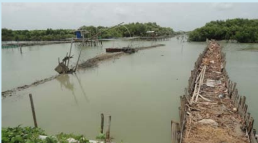
3. Kondisi tanggul baru mengalami penurunan sehingga ditambahkan material dari bekas olahan kayu, tanggul yang lama setiap saat terendam air pasang dan kondisinya makin mengencil ( 21 Mar 2018).
