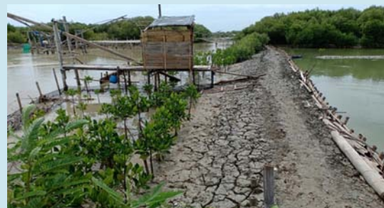
8. Untuk mempertahankan tanggul yang sudah ada pemilik tambak secara berkala menambahkan lumpur ditanggul yang mulai turun, lumpur diperoleh dari tambak bagian dalam (6 Januari 2020).
